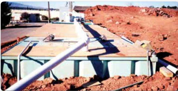
Protegida por la tierra, esta planta ADDIGEST® se encuentra semi-enterrada como se ilustra en esta fotografía.
