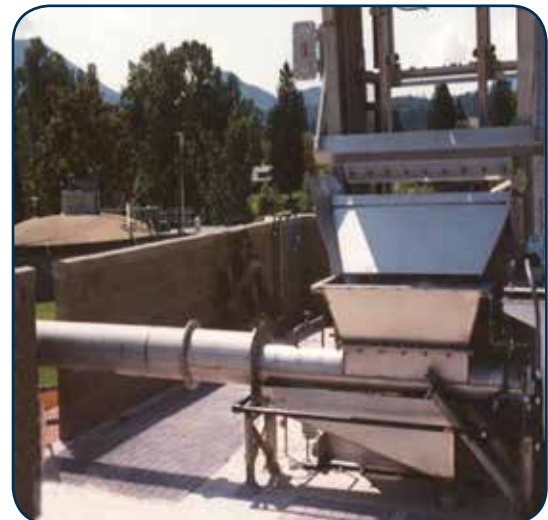
Transportador, lavador y compactador de material sólido descargado
